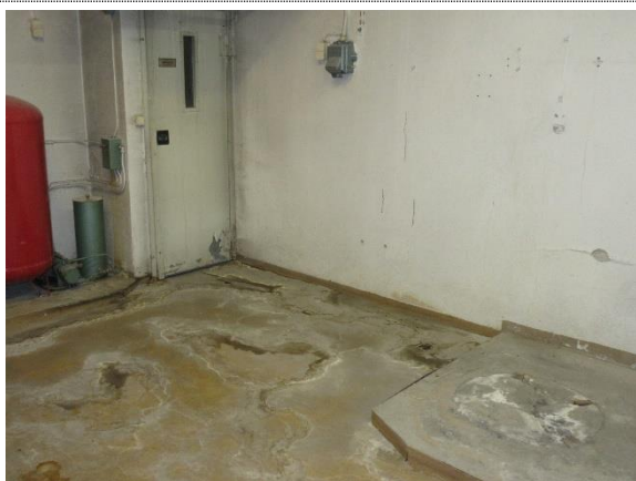
Bilde nr. 43 Teknisk rom i kjeller (nedre).
