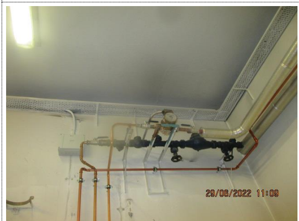
Bilde nr. 66 Lekkasje ved pumpe for varmtvann sirkulasjon.
