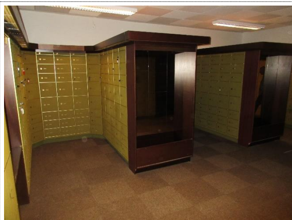
Bilde nr. 37 Bankbokser er inntakt.
