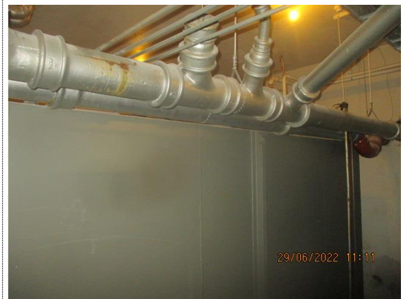
Bilde nr. 56 Avløpsrør fra 1959 er gjennomrustet flere steder.
