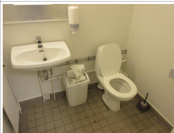
Bilde nr. 24 Toalett i 3. et. med enkel, eldre standard.
