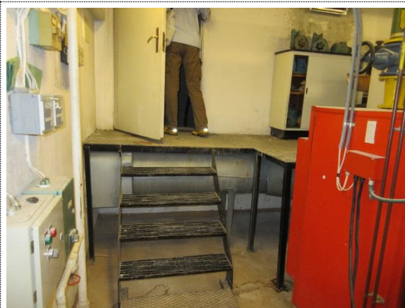
Bilde nr. 48 Trapp/repos i teknisk rom i nedre kjeller mangler rekkverk.
