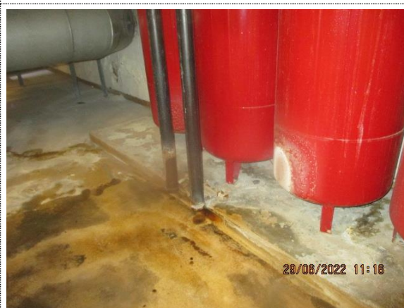
Bilde nr. 72 Ekspansjonsanlegg fra 1981 med lekkasje i sikkerhetsventil.
