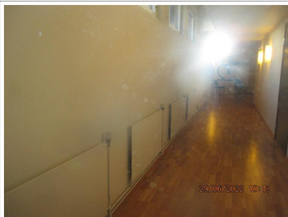
Bilde nr. 69 Enkelte radiatorer er ikke innkasset.
