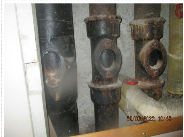
Bilde nr. 64 Gamle avløpsrør fra 1959 er modne for utskifting.
