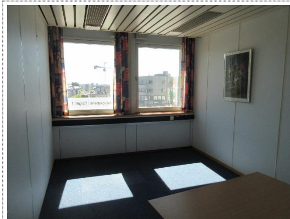
Bilde nr. 28 Cellekontorer i 2. et. med eldre standard, men i akseptabel vedlikeholdt stand.
