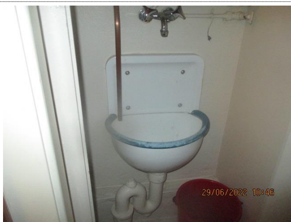
Bilde nr. 57 Gammelt sanitærutstyr og rør fra 1959.
