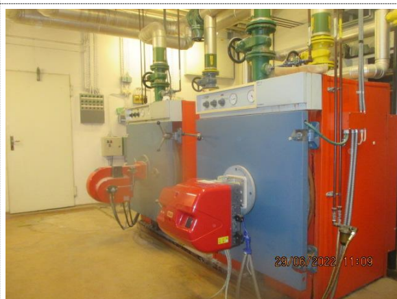
Bilde nr. 71 To oljekjeler fra 1981 – begge er konvertert til biolje og har relativt nye brennere.
