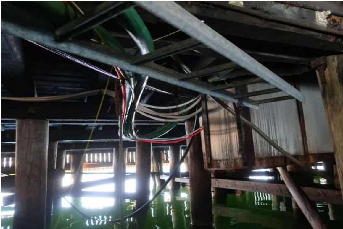
Bilde 17: Ledning/kabel, uryddig og mangelfullt oppheng
