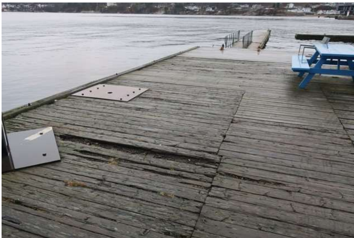
Bilde 14: Slitelag, råte
