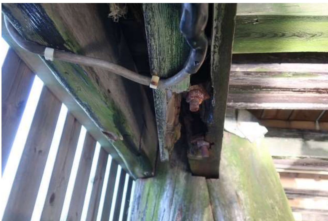
Bilde 6: Hovedbjelke, brudd
