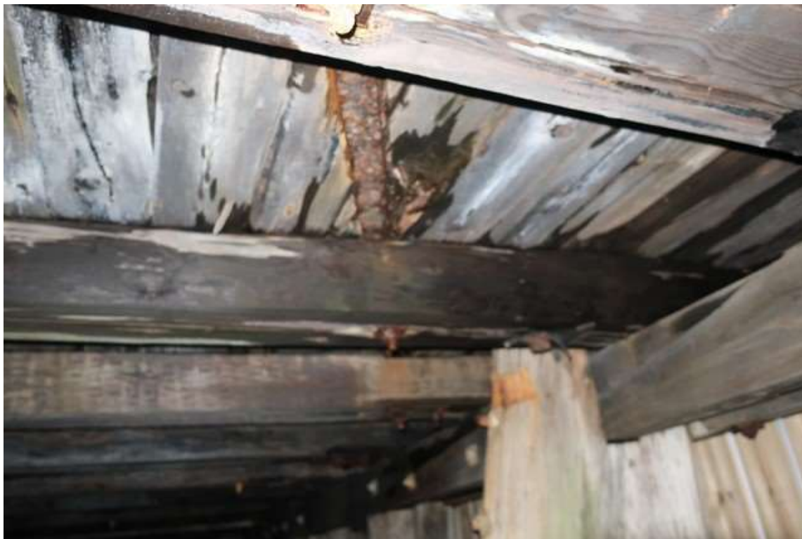
Bilde 9: Tverrkryss, korrosjon
