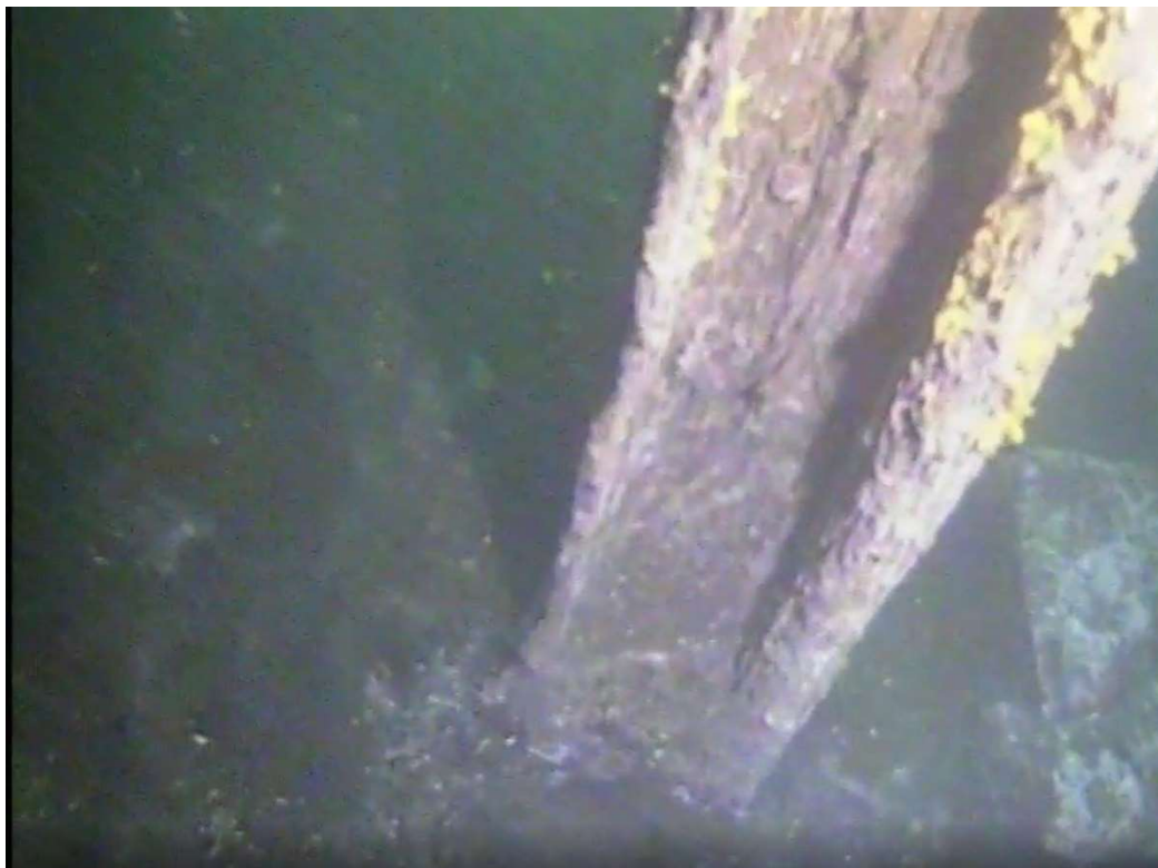
Bilde 4: Pilar, tverrsnittreduksjon
