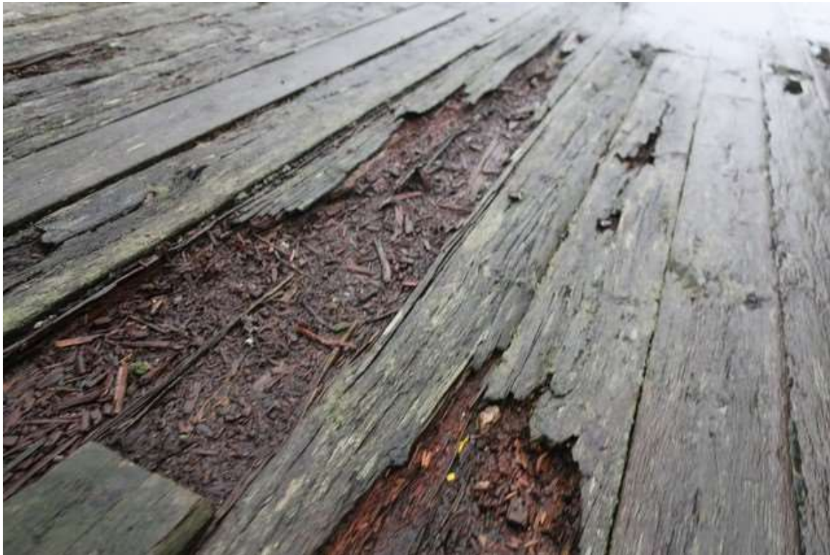
Bilde 15: Slitelag, råte
