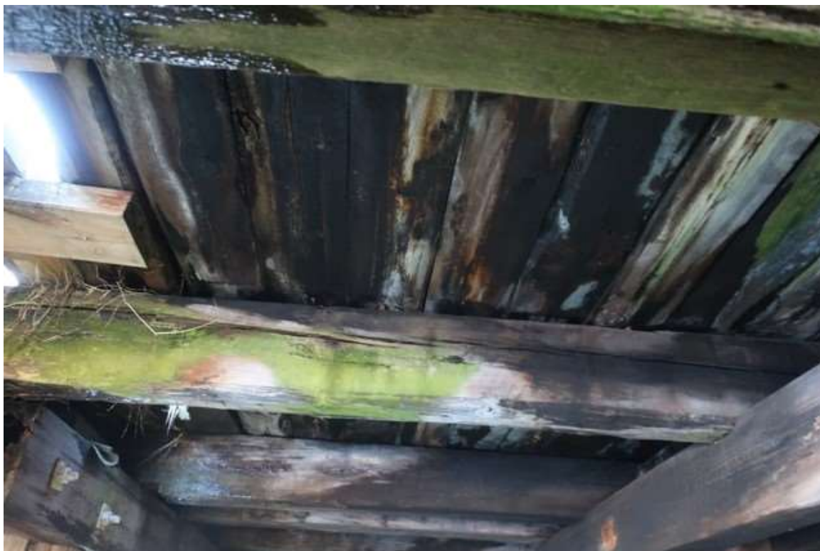
Bilde 10: Brudekke, råte
