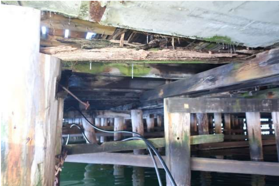
Bilde 11: Brudekke, råte- og bruddskader
