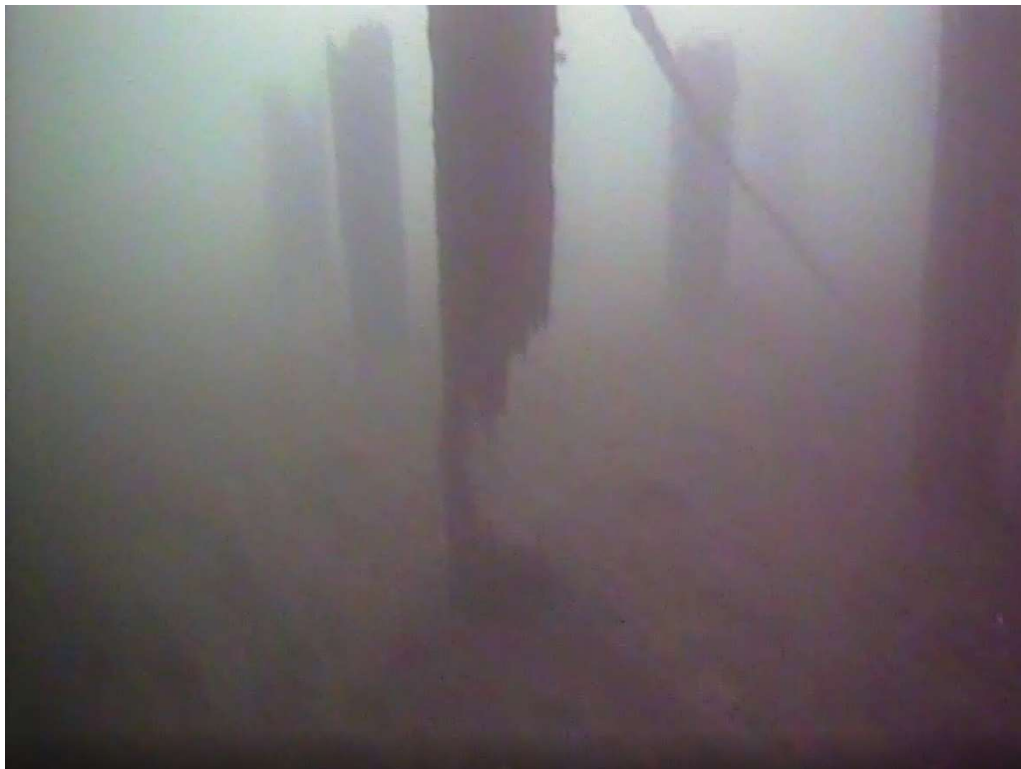
Bilde 1: Pilarer, brudd ved indre del, nord-vestre hjørne
