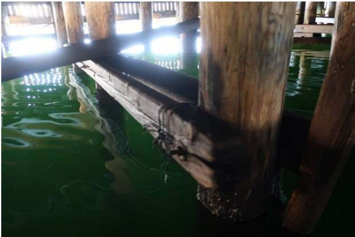
Bilde 8: Tverrkryss, sprekk/brudd
