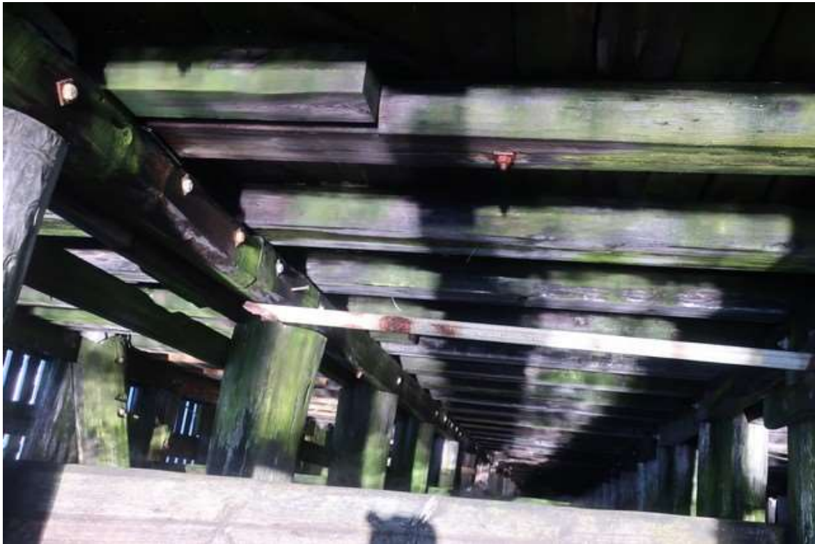
Bilde 7: Hovedbjelke, noe råte og korrosjon festemidler
