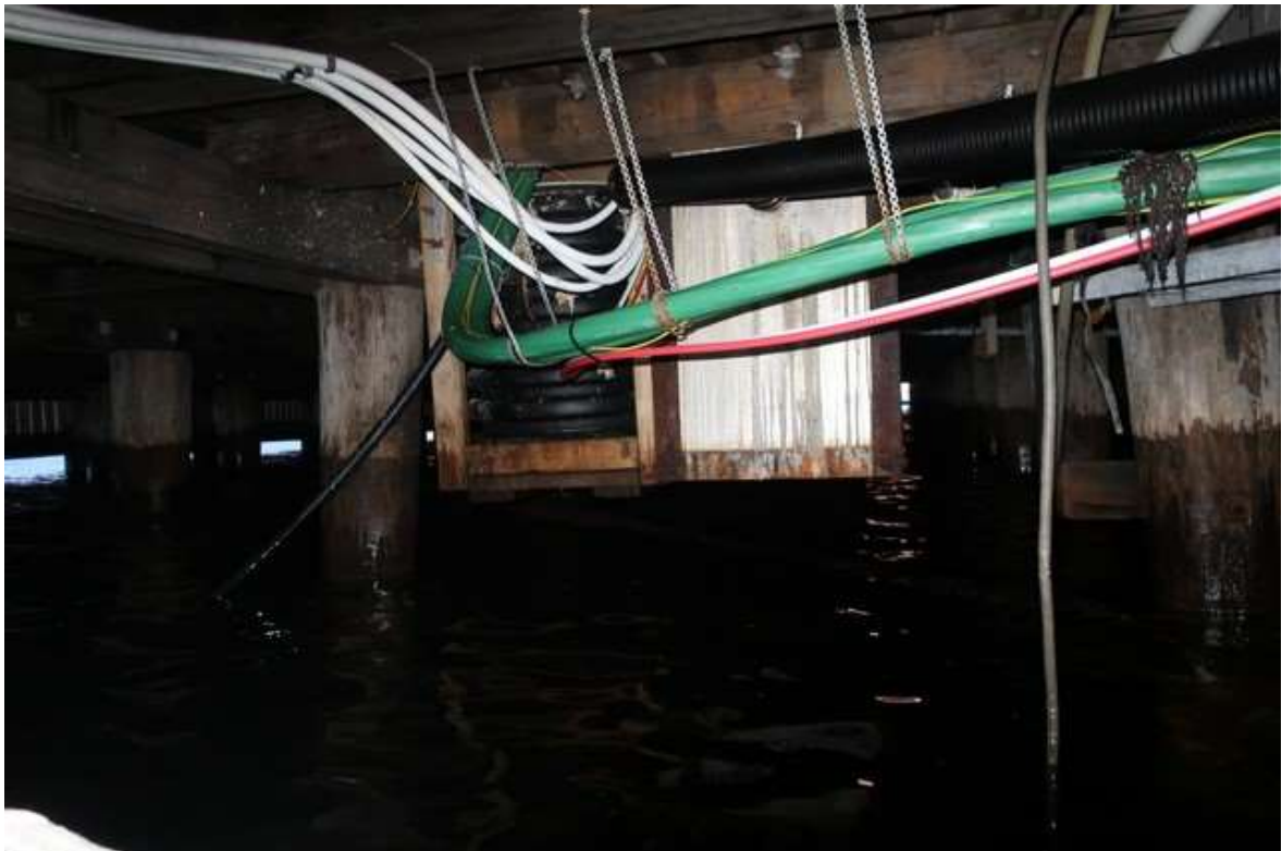
Bilde 16: Ledning/kabel, uryddig og mangelfullt oppheng
