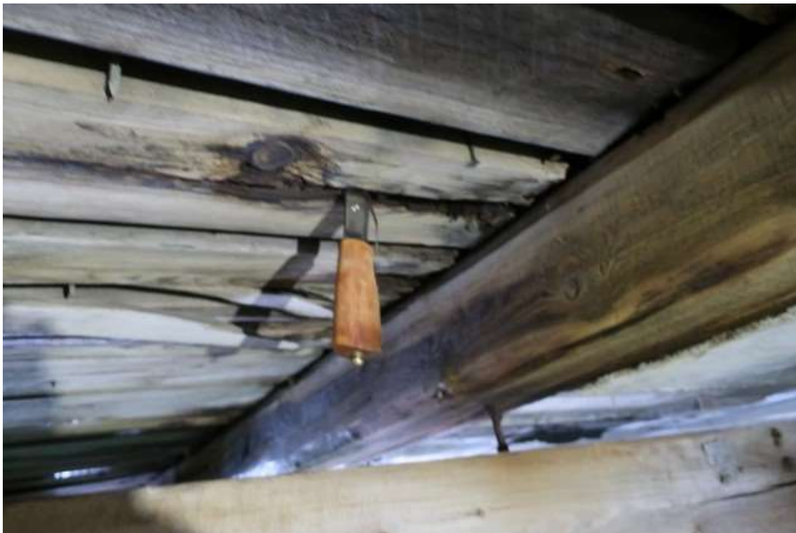
Bilde 12: Slitelag, råte
